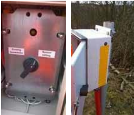
Stedlig dækning udkoblet
