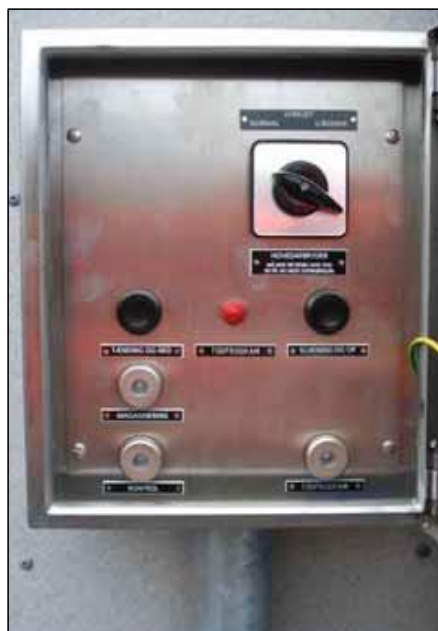
Betjeningskasse for overkørsel Ob nord for Sjællandsgade
