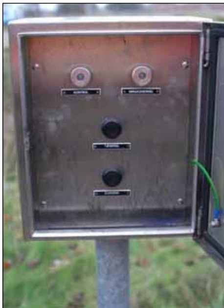
Betjeningskasse for overkørsel 0b syd for overkørslen
