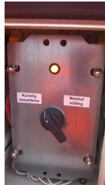
Stedlig dækning indkoblet:
