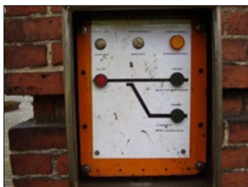
Betjeningskasse på husgavlen ved firmaet H. Daugaard.
