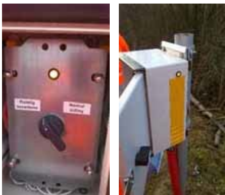
Stedlig dækning indkoblet
