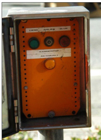
Betjeningskasse på stander på Casper Müllers Gade.
