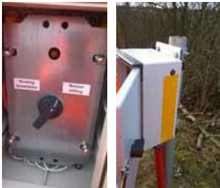
Stedlig dækning udkoblet
