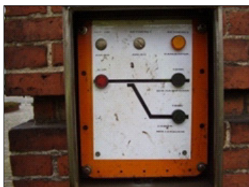
Betjeningskasse på husgavlen ved firmaet H. Daugaard.
