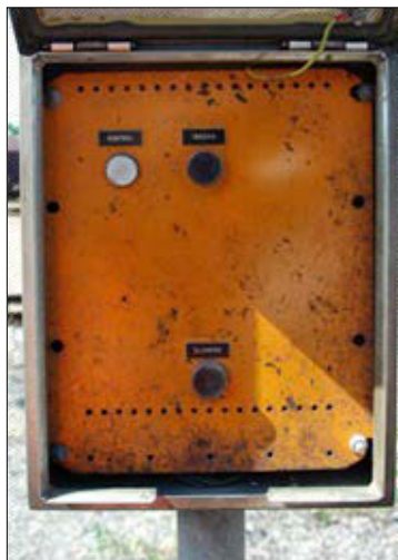
Betjeningskasse ved Jens Holms Vej.
