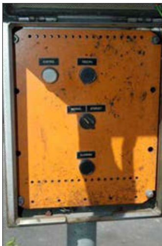
Betjeningskasse ved Nordkajen.
