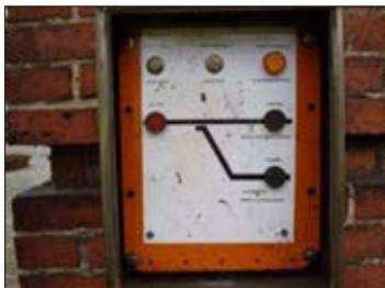
Betjeningskasse på husgavlen ved firmaet H. Daugaard.
