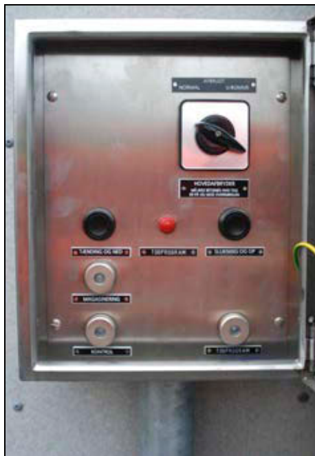
Betjeningskasse for overkørsel 0b nord for Sjællandsgade
