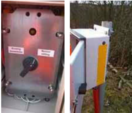
Stedlig dækning udkoblet
