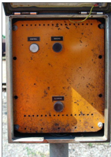
Betjeningskasse ved Jens Holms Vej.
