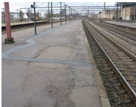
Figur 11 Forældet perron, men ikke tilstandskritisk
